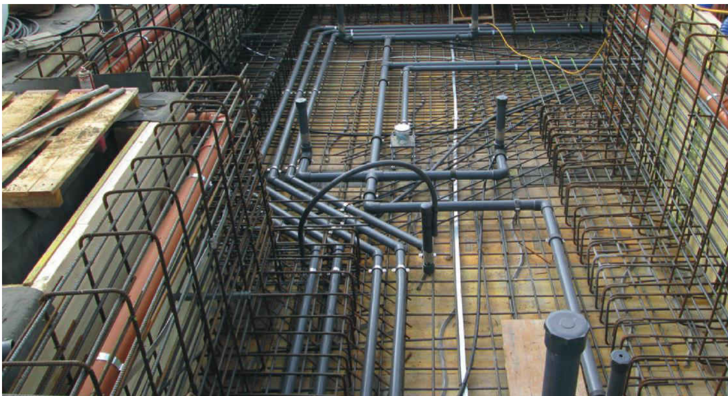
Le reti idrauliche e idroniche al servizio delle vasche balneabili, sotto le quali si trovano le vasche di compenso e i locali tecnici (Hofer Group).
